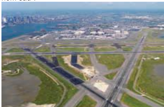
Đường băng 9-27 dài 7.000ft của Boston-Logan là đường băng bận rộn nhất của sân bay. Dự án thảm lại mặt hoàn thành được một nửa trong bức ảnh này.
